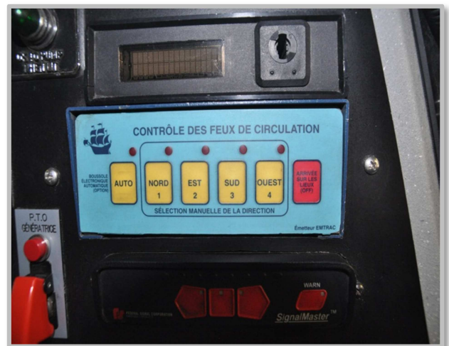
GPS et module de contrôle des feux de circulation installés dans les véhicules d'intervention.
